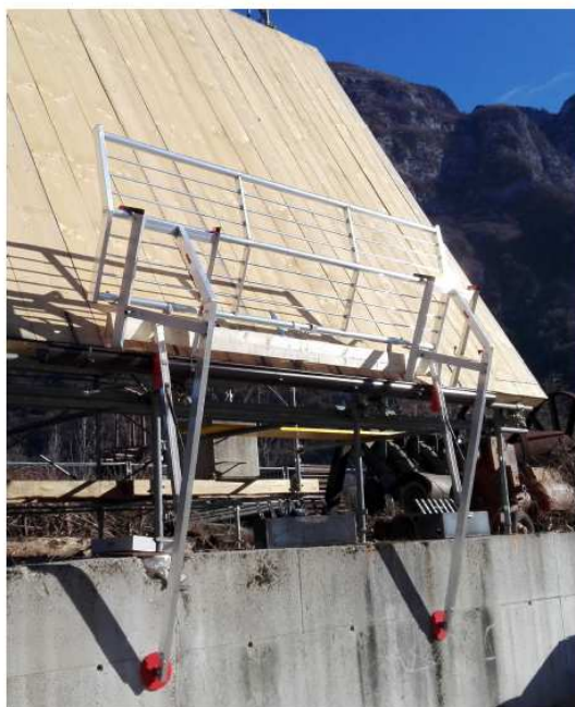
Figura 21: Immagine dell'installazione per il TEST N°2
